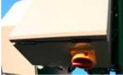
Abbildung 7: Netztrennschalter unter dem Steuerschrank
